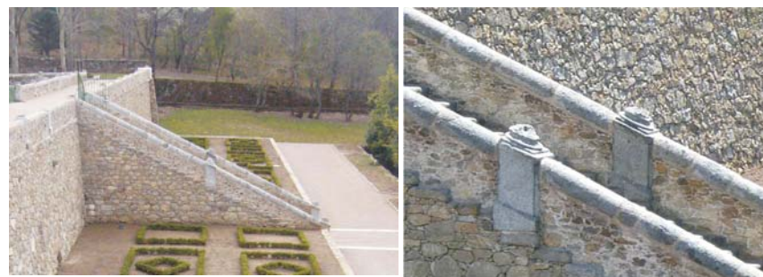
Escalera central entre la calle de el dique y la terraza de los bojes. Detalle de la escalera.
